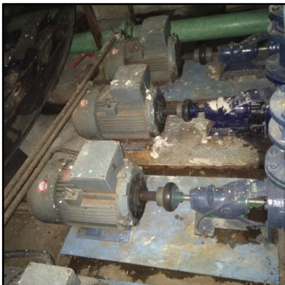
Imagen 14: Bombas de recirculación
