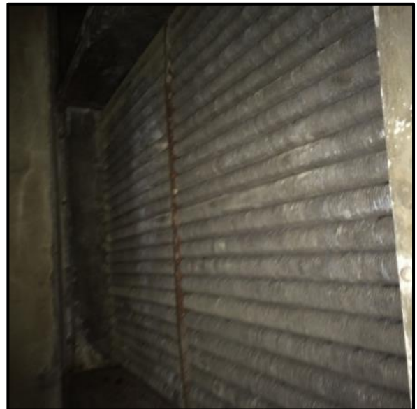
Imagen 12: Serpentina de Refrigeración
