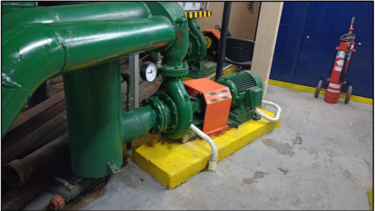
Imagen 7: Bombas de circulación de agua fría
