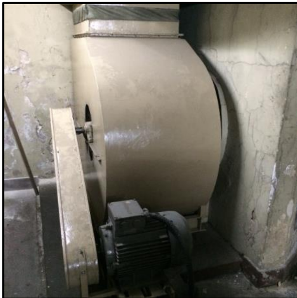
Imagen 11: Ventilador de Subsuelo
