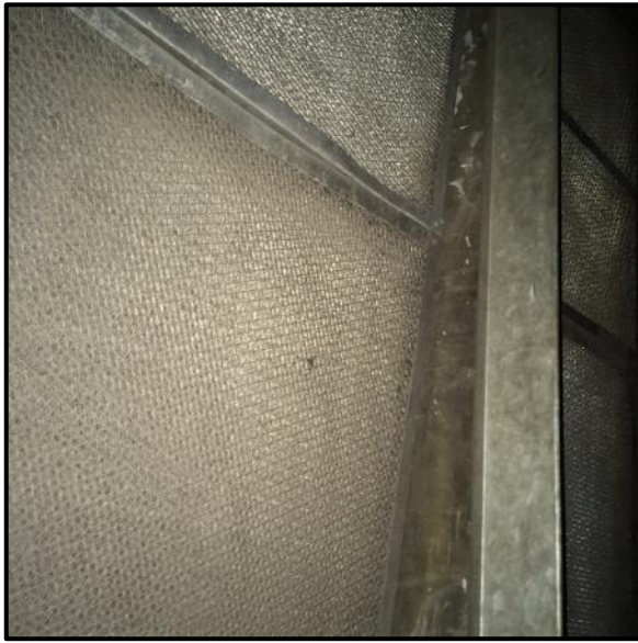
Imagen 9: Batería de Filtros
